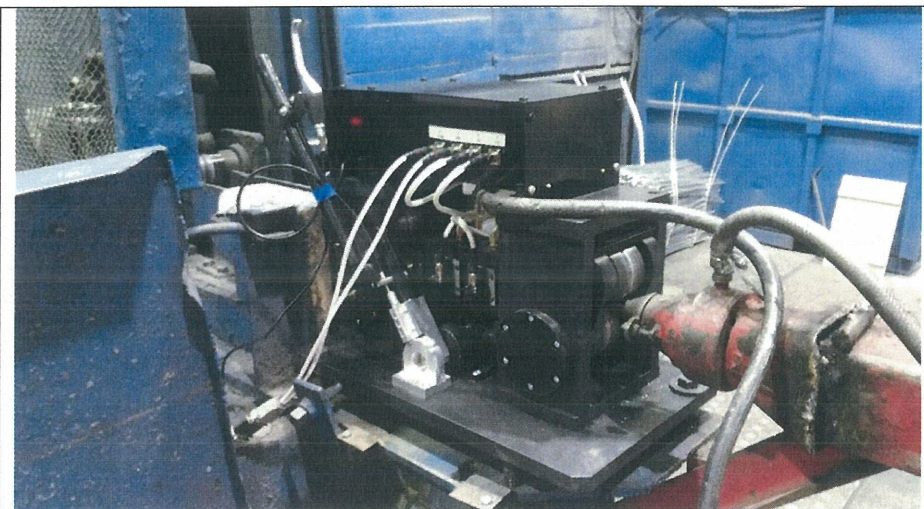
Рис.4 - ВКД ООО «АльфаСервис» 03.03.2021 г. установленный на стане № 3
